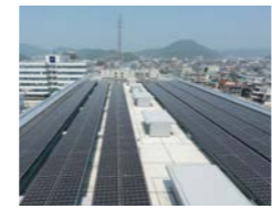
本社工場の太陽光発電
